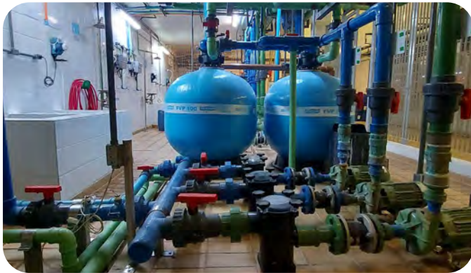
Casa de Máquinas das Piscinas | Sesc Guarulhos | Josué Cardoso
